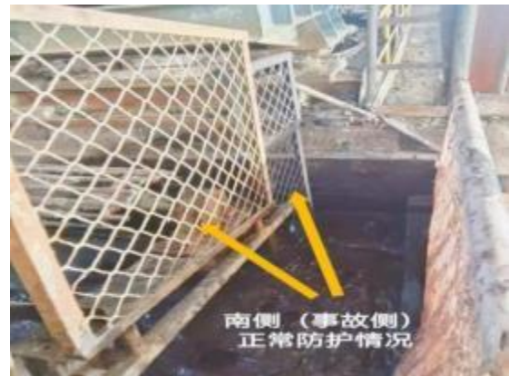
图 2 2#皮带南侧护栏（图片系事故发生后还原）
